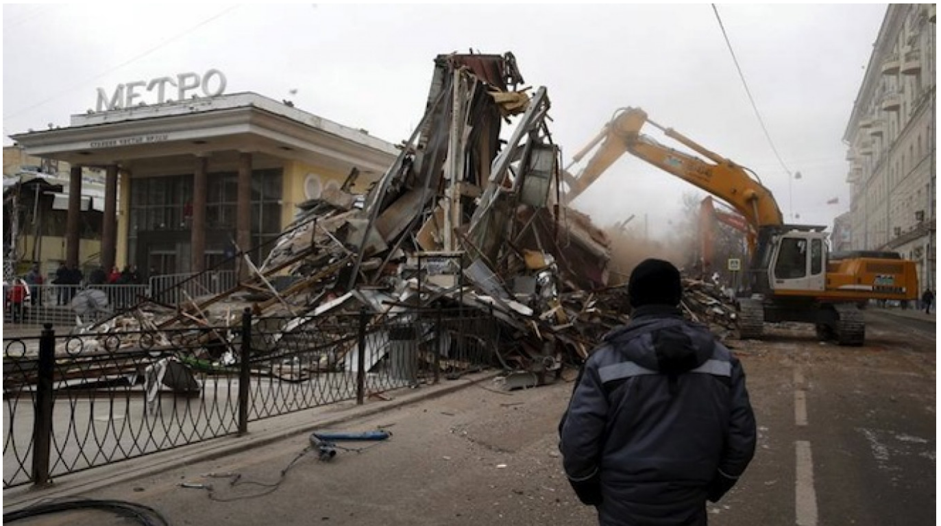
Самострой: illegal construction
